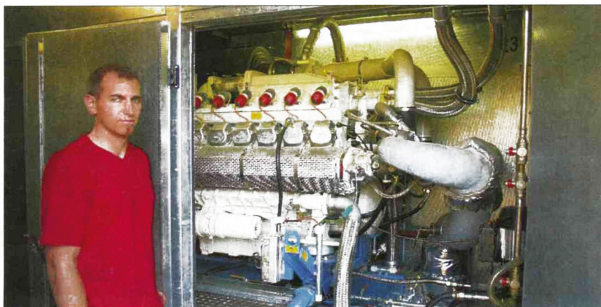
Hightech auf dem Bauernhof: Landwirt Matthias Preußner vor dem biogasbetriebenen Generator, der eine Leistung von 370 KW bringt. Fotos: Kreisverwaltung/pv
